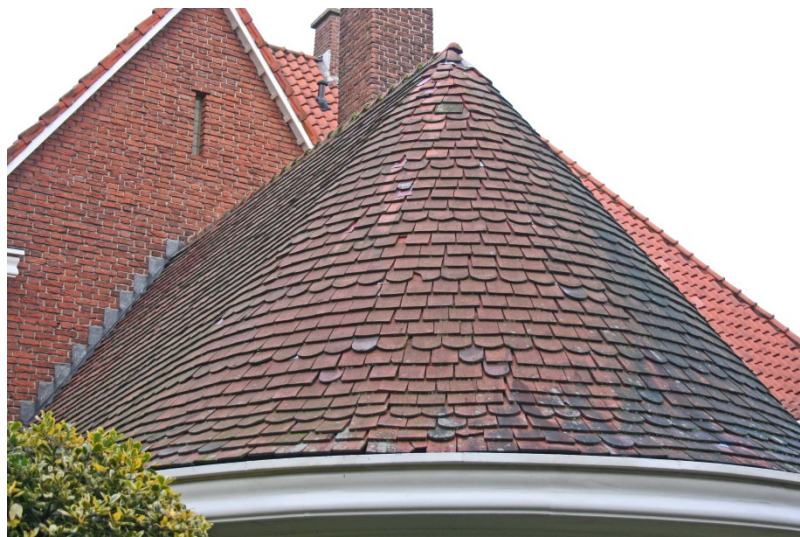
Figuur 10: Een dak van een serre van een woonhuis uit circa 1930, belegd met leipannen in twee vormen. Door te weinig zijdelings overlap is de onderconstructie door lekkage sterk aangetast.
