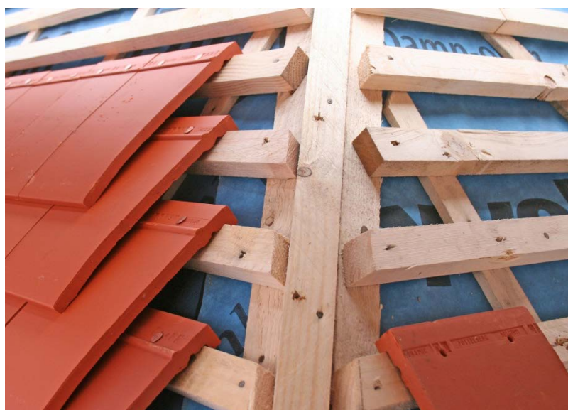
Figuur 11: Vernieuwen in de categorie 3B Imiteren met nieuwe leipannen. De leipannen worden op latten aangebracht. De juiste overlap plus latafstand staat in de ontwerp- en uitvoeringsrichtlijnen voor dakbedekkingsconstructies met keramische en betonnen leipannen PBL 24-103: 2011.
