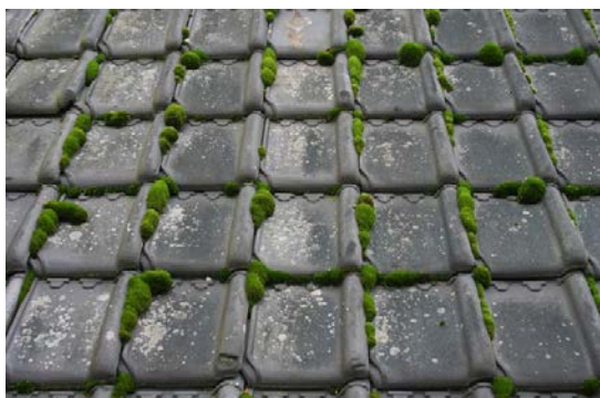
Figuur 1: Bij flauwer hellende dakvlakken blijft veel water lang in de zijsluiting hangen, waardoor afvoer van regenwater stagneert en sterke groei van kussentjesmos ontstaat. Tijdig verwijderen voorkomt lekkages.
